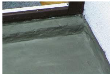
Fot. 1. Uszczelnienie Hydrostopem-Elastycznym 2,0kg/m 2 , cienkiej, podatnej na zarysowania wylewki tarasu ocieplanego. Wylewka ma grubość 5cm i jest zbrojona siatką Rabitza. Dodatkowo styki wylewki w narożnikach będą doszczelnione Hydrostopem-Elastycznym Zbrojonym.
